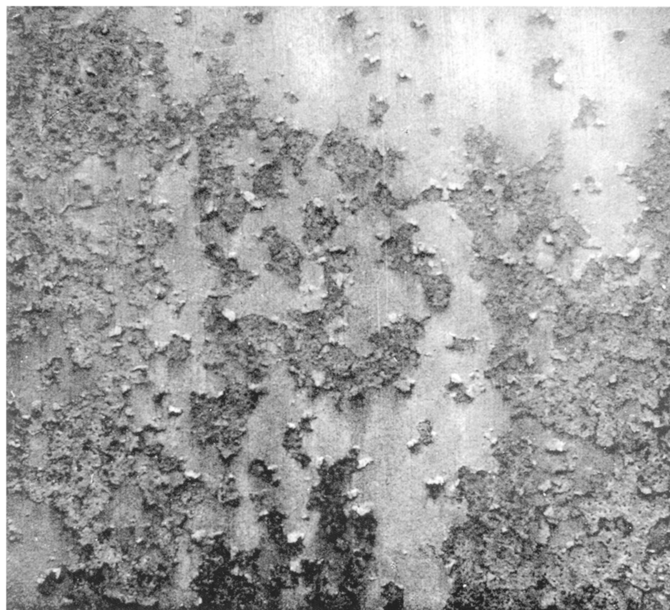
Рисунок 13 — Коррозия металла балл K5 (или R5)
